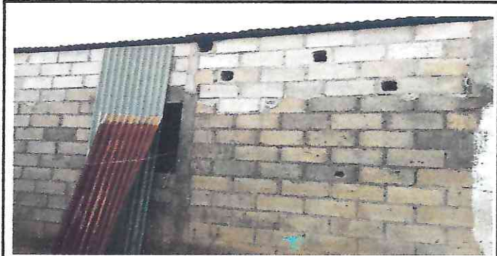
REMODELACION DE COCINA, CAMBIO DE LAMINA POR LÁMINA TROQUELADA, SUSTITUCION DE ESTRUCTURA METALICA, PINTURA, Y ESTUFA RURAL
