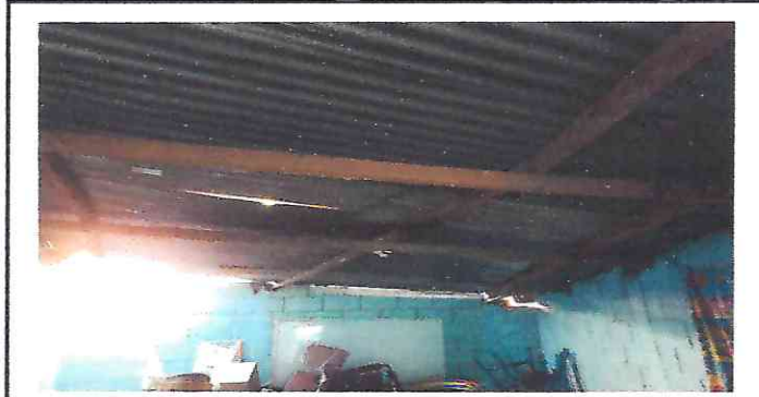
SUSTITUCION DE LAMINA, POR LAMINA TROQUELADA Y SUSTITUCION DE ESTRUCTURA DE SOPORTE DE METAL
